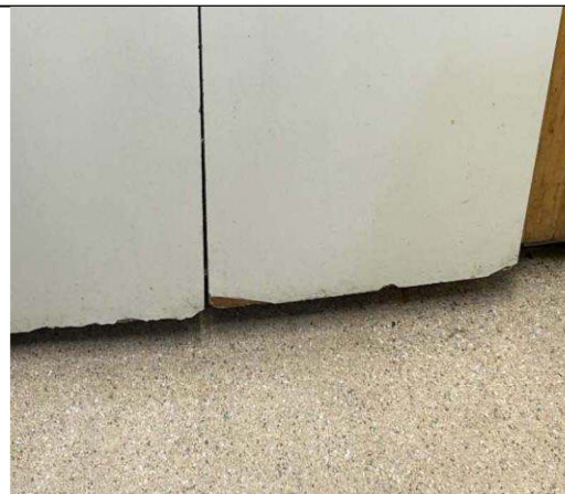
Armarios de cocina desconchados/desgastados
