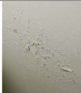
Pintura de la cocina descascarillada/desprendida
