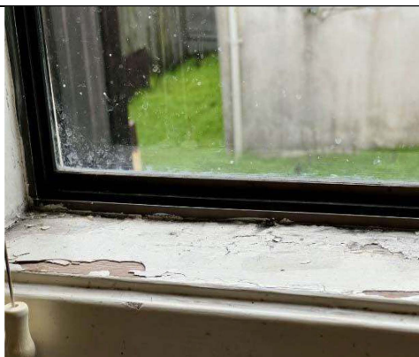
Pintura del alféizar de la ventana descascarillada
