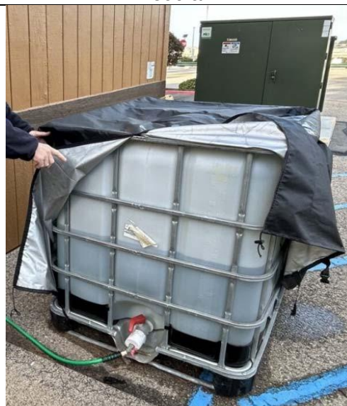
Suministro de agua no potable
